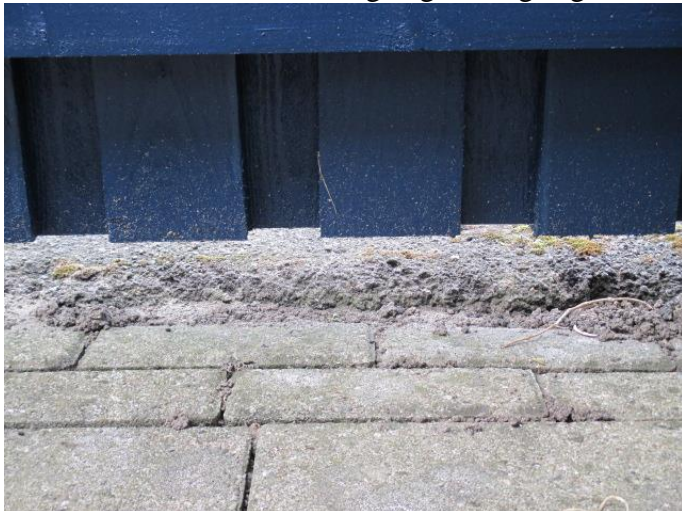
Foto 1. Asfaltkant efter udlægning, belægningssten under asfalteniveau
