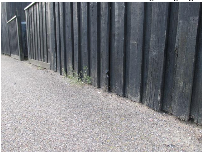
Foto 3. Lille afstand mellem brædder og belægning
