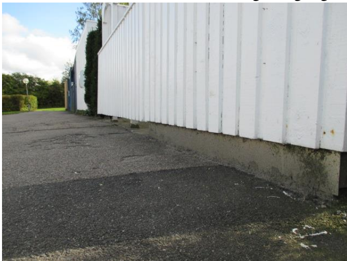
Foto 4. Stor afstand mellem brædder og belægning
